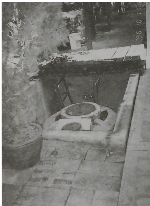
ถังบำบัดน้ำเสียซึ่งเป็นระบบเรียกทางวิชาการว่า SEPTIC TANK ต่อด้วย SYNTHETIC MEDIA ANAEROBIC FILTER มีชื่อการค้าว่า “BIOTOL”
