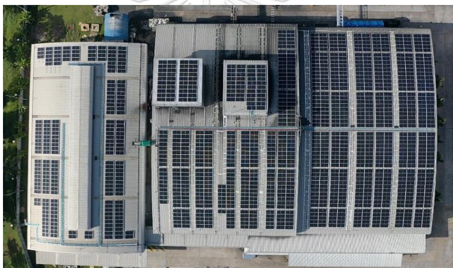
รูปภาพที่ 37 ระบบเซลล์สุริยะที่ติดตั้งบนหลังคาโครงการที่ 2
